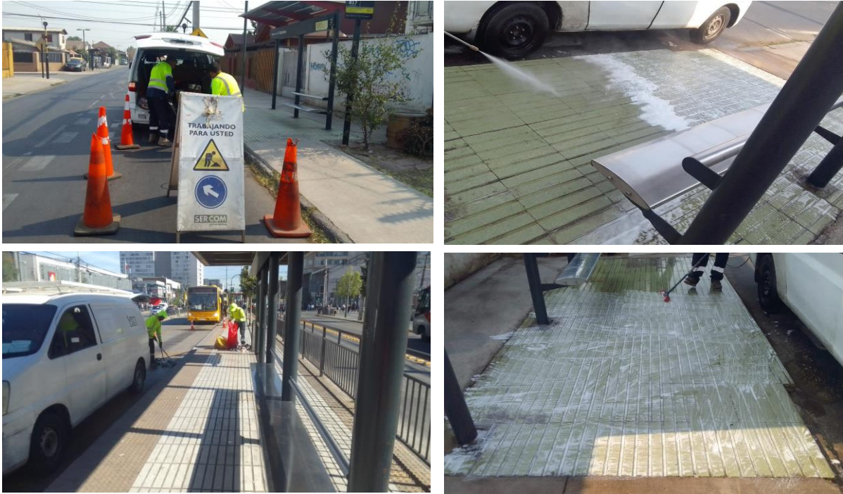
Fotografía de Mantenimiento de Paradas Red MTT
